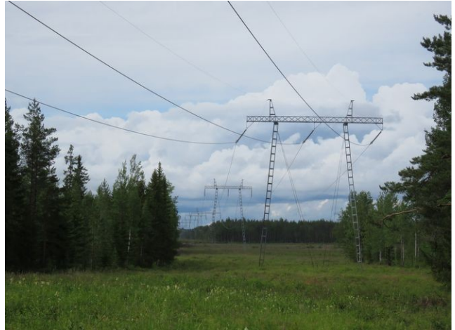
Kuva 3. .Länsiosan halki menevä voimalinja, kuvattu lounaaseen.
